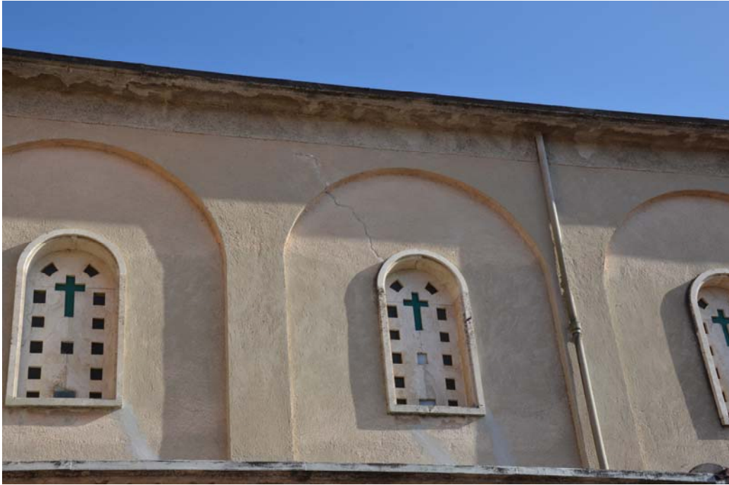
Controfacciata con particolare delle lesioni e infiltrazioni
