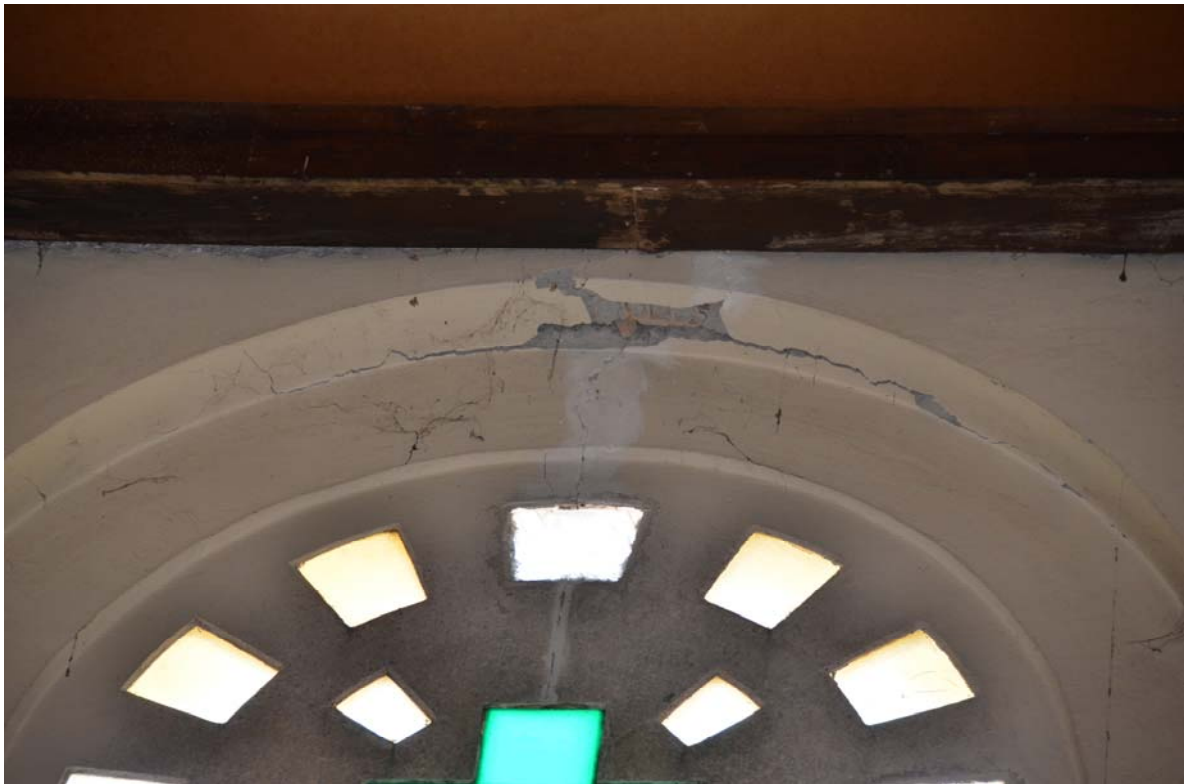
Controfacciata con particolare delle lesioni
