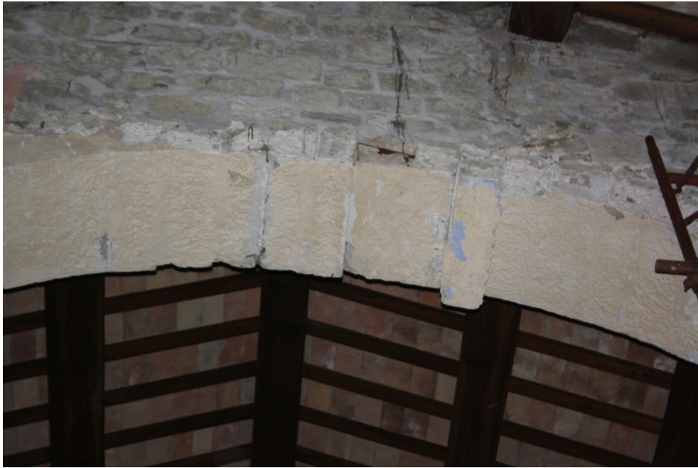
Particolare danneggiamento arco interno
