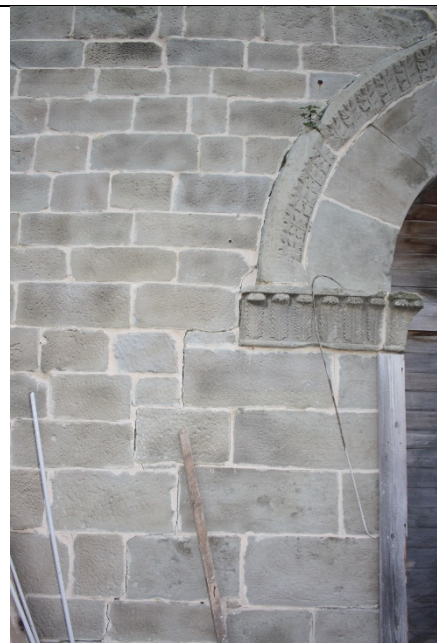
Particolare lesione a lato del portale d'ingresso
